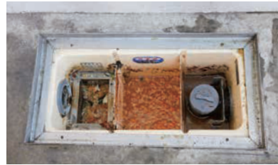
グリストラップクリーンシステム設置前
